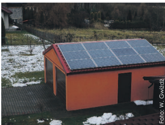
Instalację fotowoltaiczną można umieścić nawet na niewielkim budynku gospodarczym.
