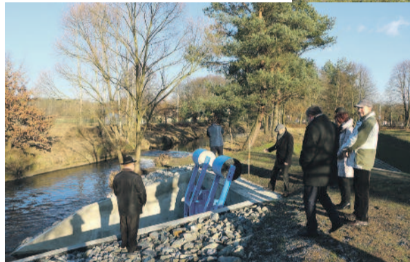
Kłapy zwrotne zamkną się, gdy poziom wody w rzece nadmiernie wrośnie.
