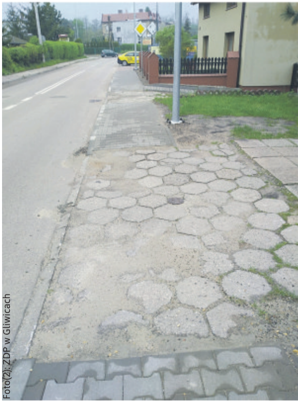
Knurów: remont chodnika w ciągu drogi powiatowej – poprawa stanu technicznego zjazdu pozostałe w gestii prywatnych właścicieli.
