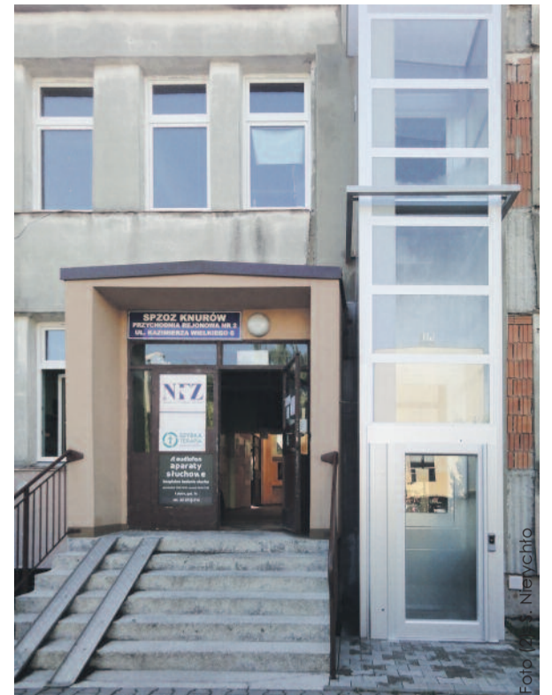
W przychodni przy ul. Kazimierza Wielkiego trwa przebudowa – wymienione zostały już okna, a niezwykle ważnym i potrzebnym udogodnieniem dla pacjentów niepełnosprawnych jest dobudowana przy wejściu winda.
