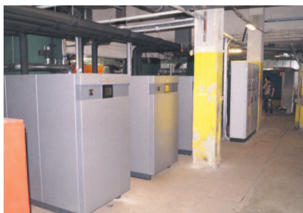
...instalacji, której najważniejszą częścią są pompy ciepła.
