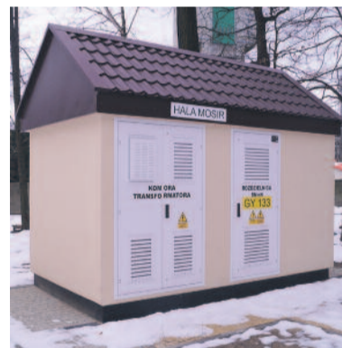
System uzupełnia własną stację transformatorową.
